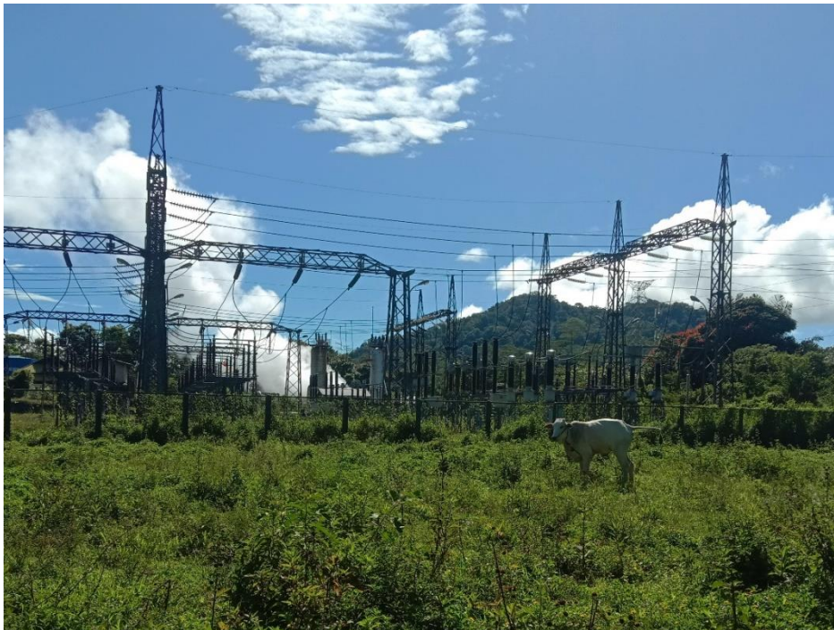
Gambar 12. Area Selatan Transformator
